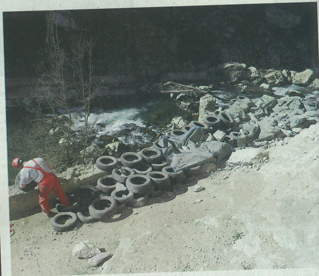
Des pneus ont été disposé au sol pour amorir les chutes de pierres. / Photo DDM.
